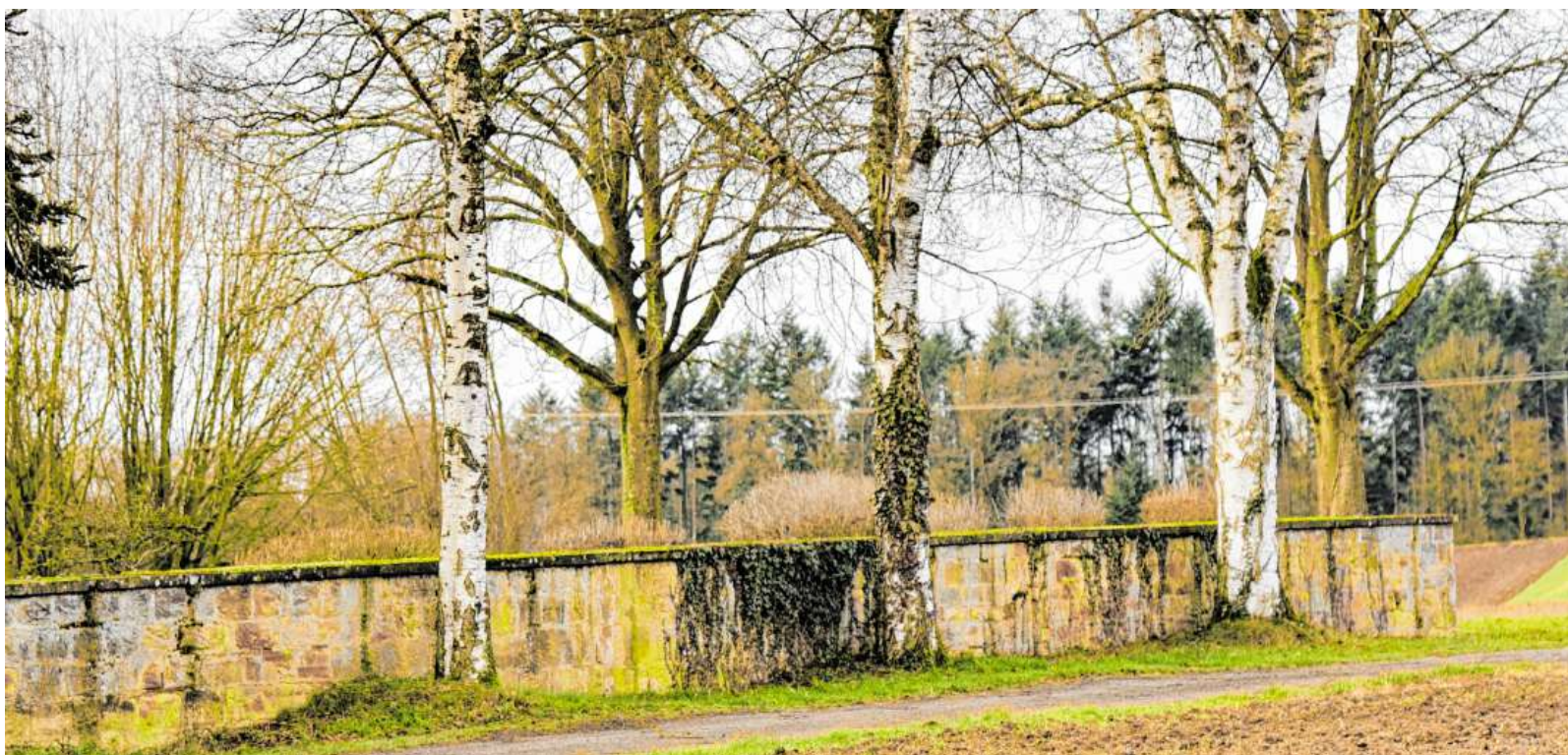
Die Birken am Friedhof in Höhefeld dürfen vorerst stehen bleiben, da bisher keine erkennbaren Schäden an der Mauer entstanden sind.
